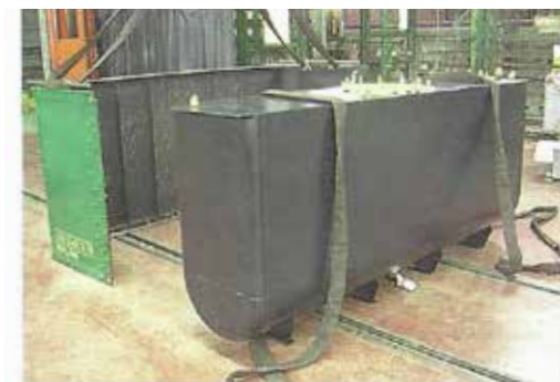
Der Öltank wurde im Kohlenkasten eingepasst
